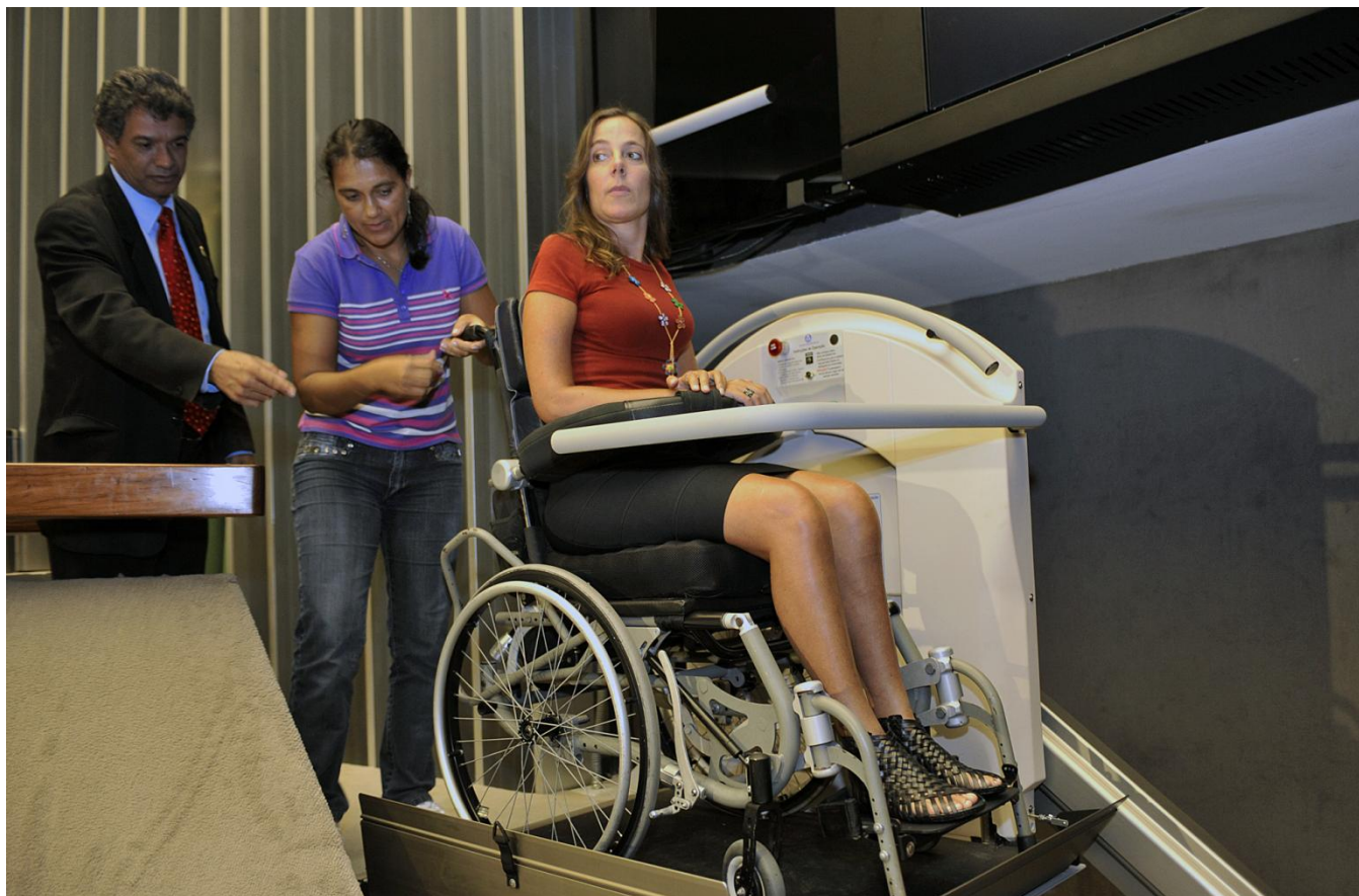
Plataforma elevatória no Plenário Ulysses Guimarães
